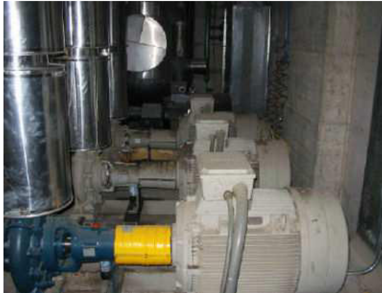
Pompaggio rete TLR
