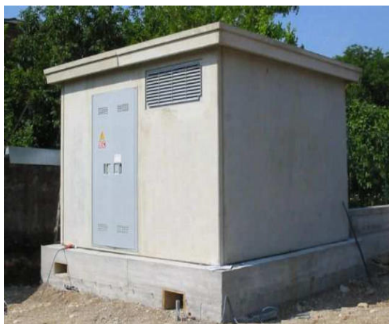
Tipica cabina fuori terra di trasformazione MT/BT
