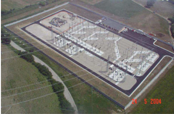
Stazione elettrica AAT da 380 kV
