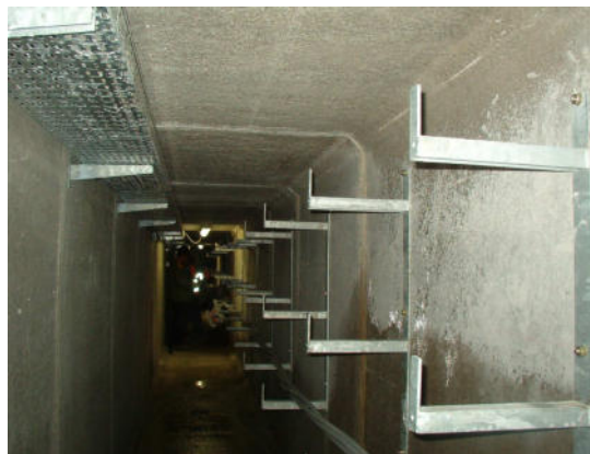
Galleria tecnologica predisposta per l'alloggiamento delle reti in altro comune
